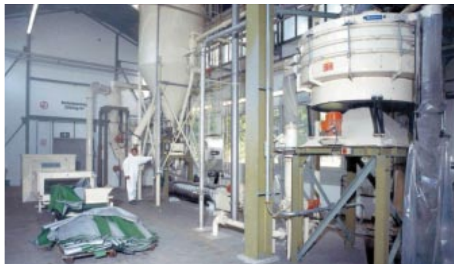
Abb. 4: Recyclinganlage für Dachbahnen in Troisdorf (95.30.64-f)
