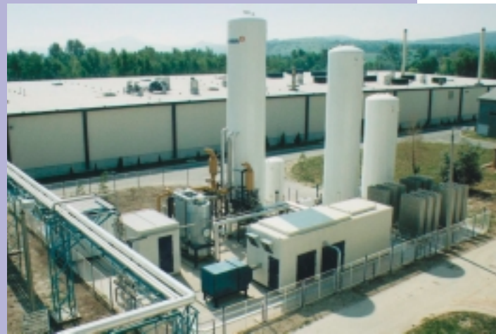
Abb. 7: Stickstoff-Generator bei der Firma Zoltek in Ungarn
