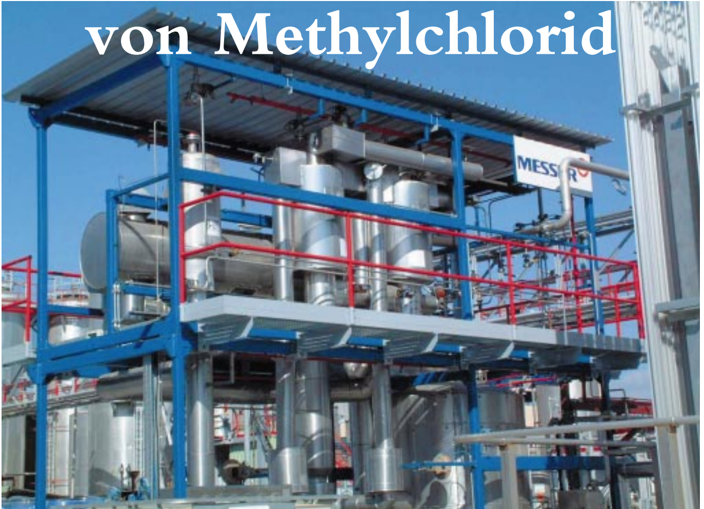
Abb. 1: Cryosolv®-Anlage zur Rückgewinnung von Methylchlorid bei Goldschmidt España in Barcelona (95.00.75a)
