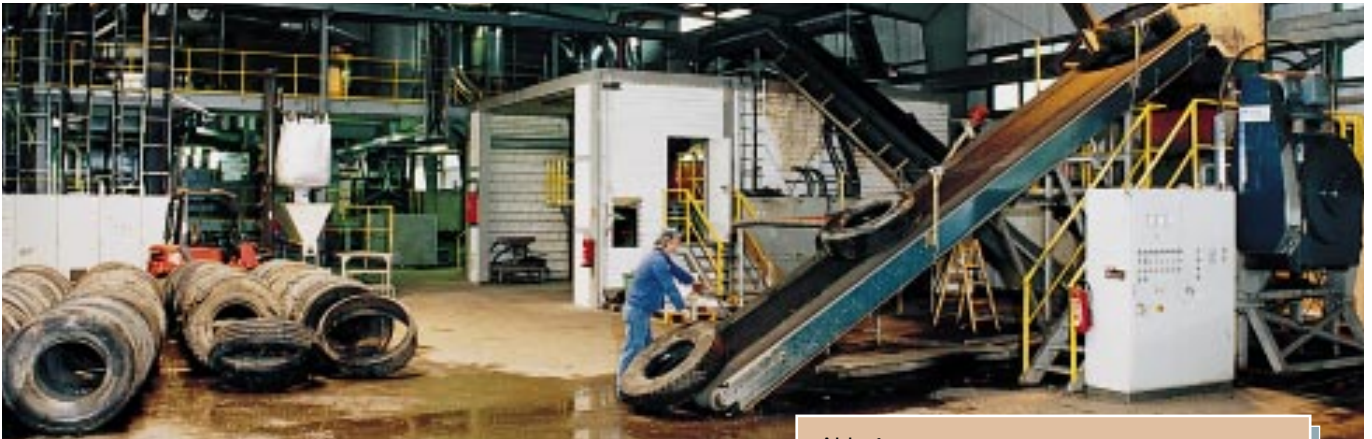
Abb. 1: Shredder- und Vorzerkleinerungsanlage bei der Mülsener Recycling GmbH (95.30.76.a-1)
